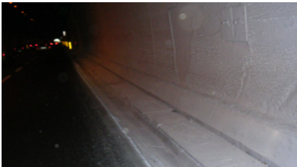
Fig. 68 - Delineatori assenti (galleria Vomero, carreggiata ovest)
