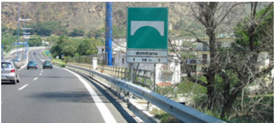
Fig. 23 - Viadotto Domitiana: barriera di sicurezza con bassa capacità di contenimento
