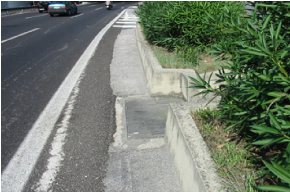
Fig. 44 - Ostacolo in calcestruzzo (carreggiata est, km 13 + 300)
