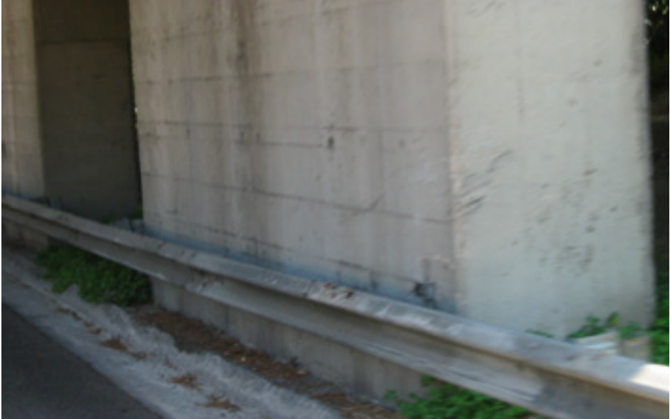
Fig. 43 - Pila di ponte con protezione inefficace (carreggiata est, km 7 + 000)
