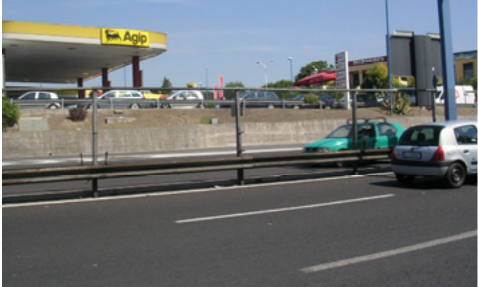
Fig. 28 - Barriera per spartitraffico con bassa capacità di contenimento (km 19 + 400)
