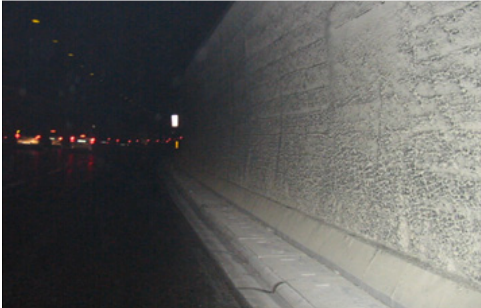
Fig. 69 - Delineatori assenti (galleria Capodimonte, carreggiata ovest)
