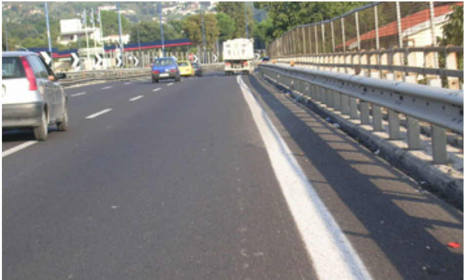
Fig. 74 - Mancanza di visibilità dell'immissione all'area di servizio "Antica Campana"
