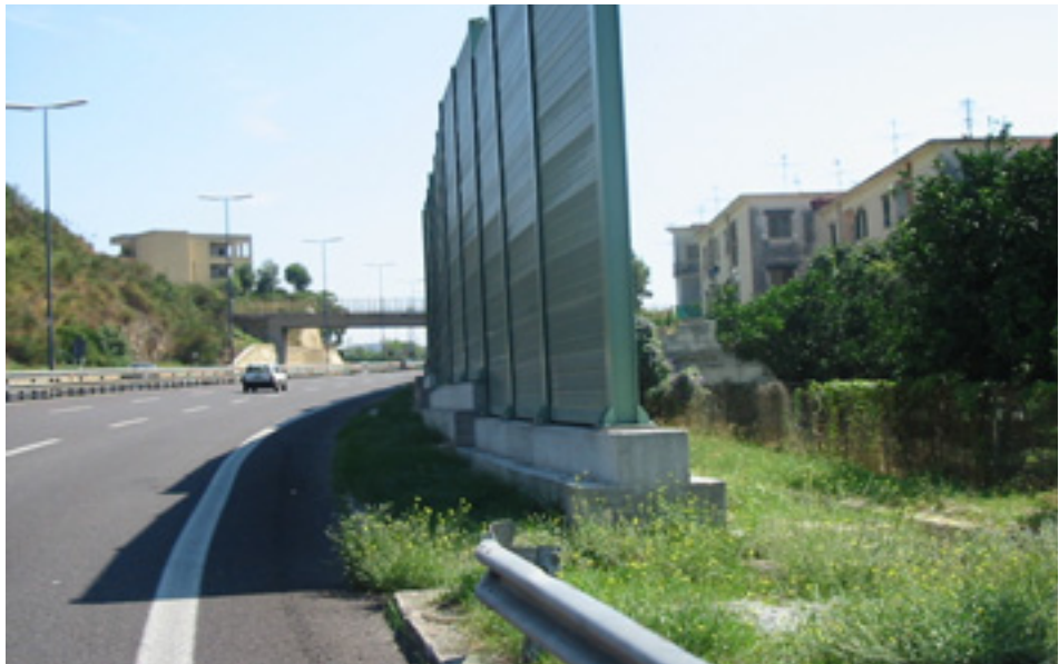
Fig. 42 - Ostacolo in calcestruzzo con protezione inefficace (carreggiata est, km 1 + 500)
