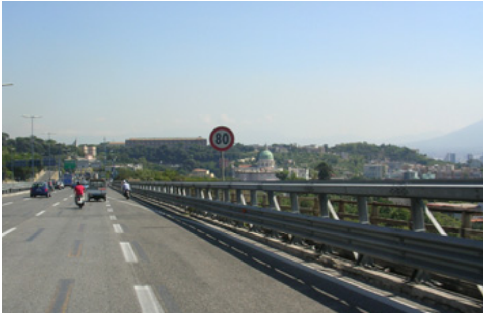
Fig. 54 - Segnaletica orizzontale degradata (carreggiata est, km 15 + 500)
