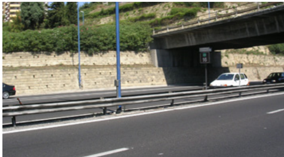
Fig. 27 - Barriera per spartitraffico con bassa capacità di contenimento (km 13 + 600)
