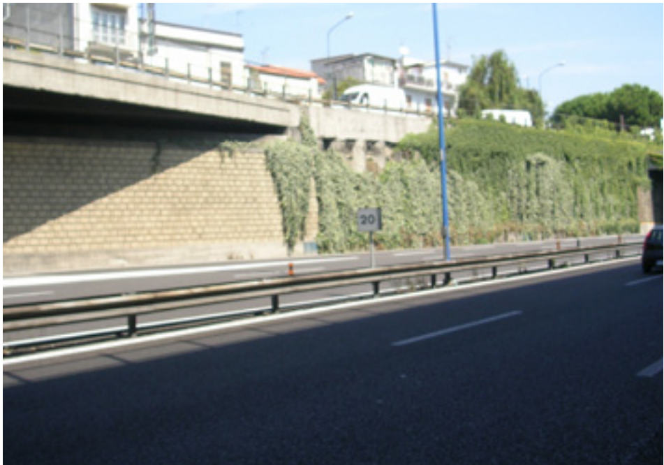
Fig. 29 - Barriera per spartitraffico con bassa capacità di contenimento (km 20 + 000)
