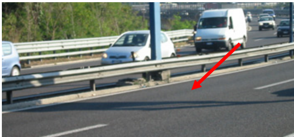
Fig. 26 - Barriera per spartitraffico con bassa capacità di contenimento (km 13 + 300)
