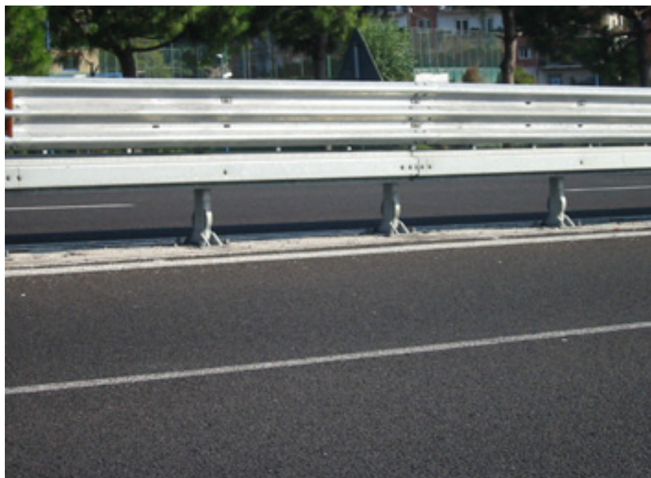
Fig. 16 - Barriera di sicurezza pericolosa per i motociclisti
