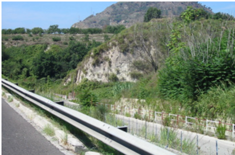
Fig. 25 - Carreggiata ovest, km 4 + 000: barriera con bassa capacità di contenimento in corrispondenza di un rilevato di notevole altezza al cui piede è presente una strada
