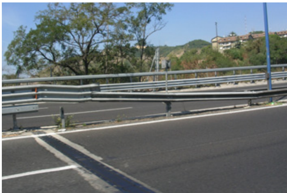
Fig. 33 - Barriere collegate con inadeguata transizione (km 12 + 500)
