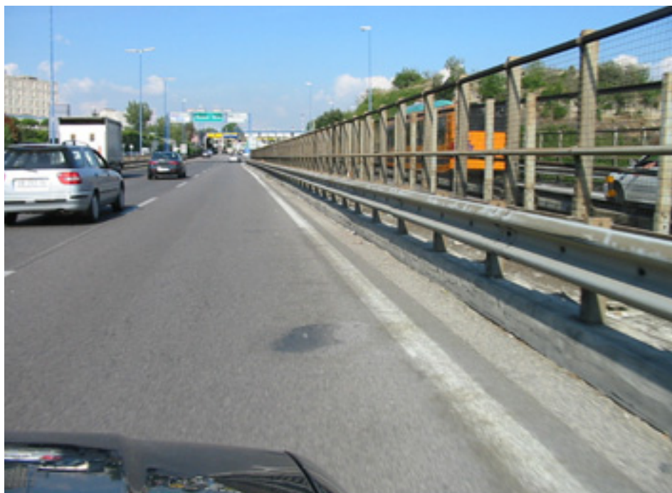
Fig. 53 - Segnaletica orizzontale degradata (carreggiata est, km 19)
