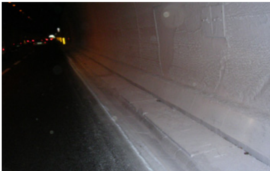
Fig. 71 - Segnaletica orizzontale degradata (galleria Vomero, carreggiata est)
