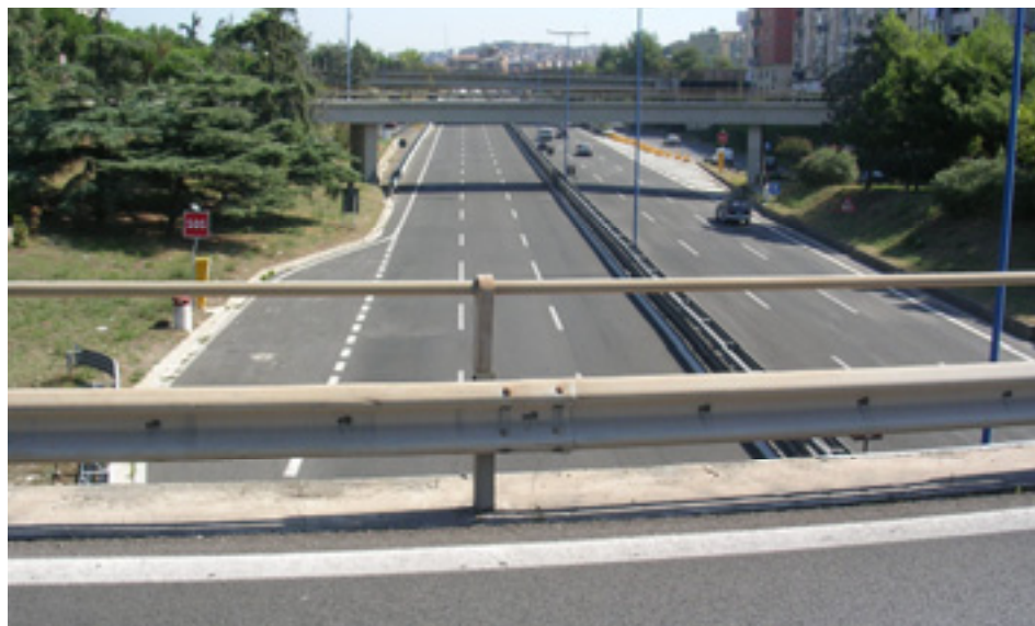
Fig. 24 - Svincolo Fuorigrotta: barriera di sicurezza per bordo ponte con bassa capacità di contenimento
