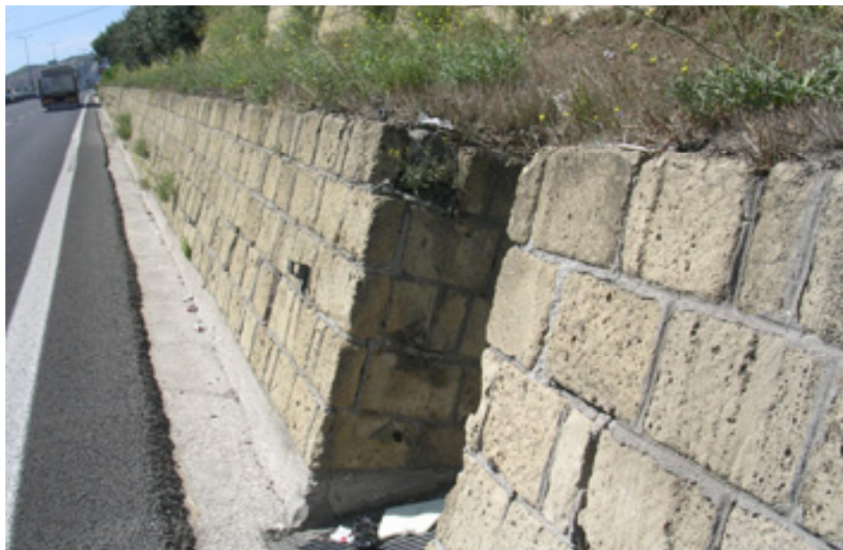
Fig. 45 - Spigoli di muro esposti al traffico (carreggiata ovest, km 6)
