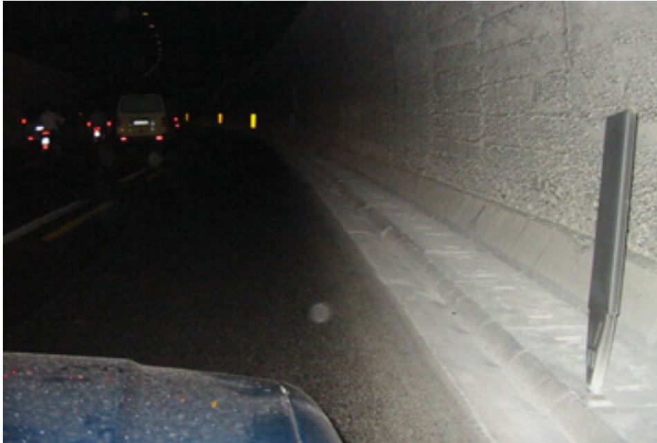
Fig. 70 - Delineatori assenti (galleria Capodimonte, carreggiata ovest)
