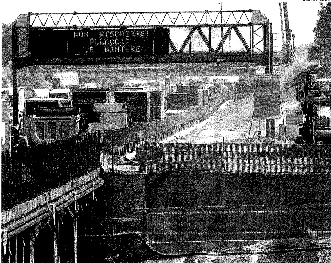
Verso il controesodo. Cantieri e lavori sulla via del ritorno dalle vacanze estive
