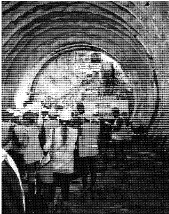
Operai al lavoro nel cantiere della Torino-Lione a Saint Martin la Porte
