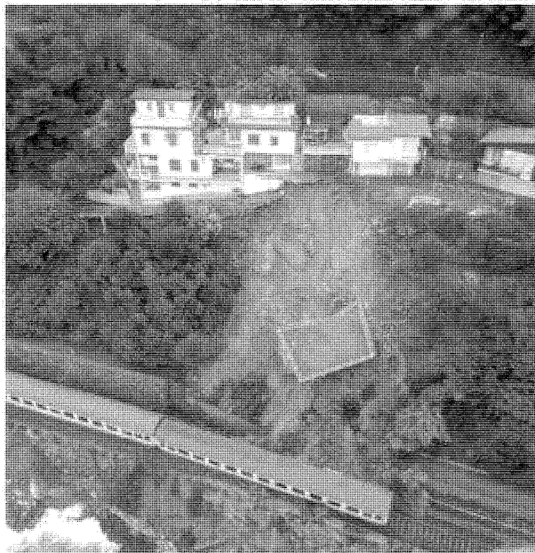
Lo smottamento di Capo Rollo Il costone crollato sotto il peso della terrazza il 17 gennaio 2014. La ferrovia restò chiusa per tre mesi
