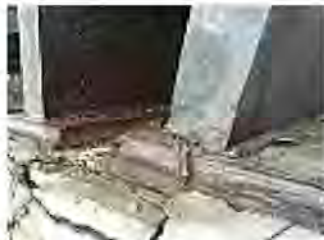
I piloni usurati sulla tangenziale a Rho
